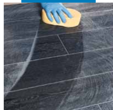
Curățarea și finisarea chitului de rosturi cu un burete rigid din celuloză
