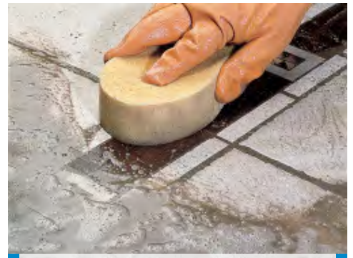
Curatarea si finisarea placilor ceramice cu insertii din lemn, utilizand buretele dur din celuloza Mapei
